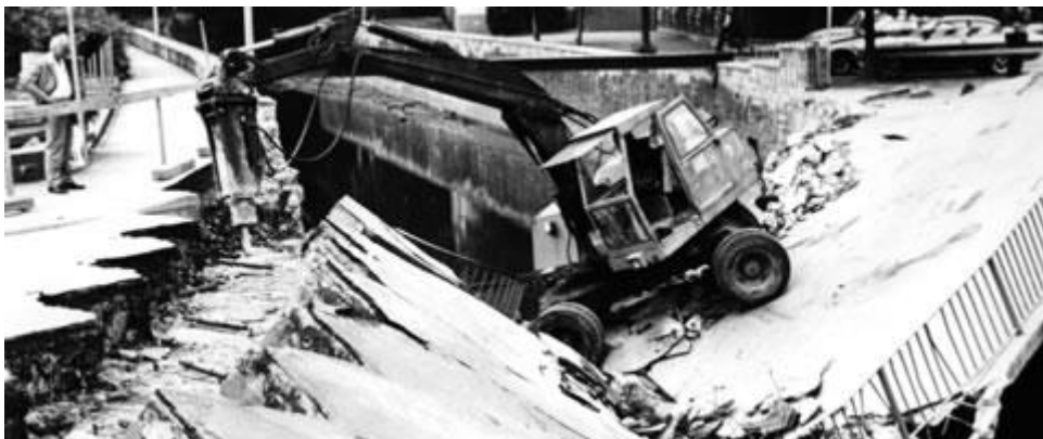
Bei Arbeiten im Zuge des Baus der Südtangente stürzt Anfang Juli die zum Abriss vorgesehene alte Metterbrücke vorzeitig ein. Fotograf: Köhler (Bietigheimer Zeitung).
